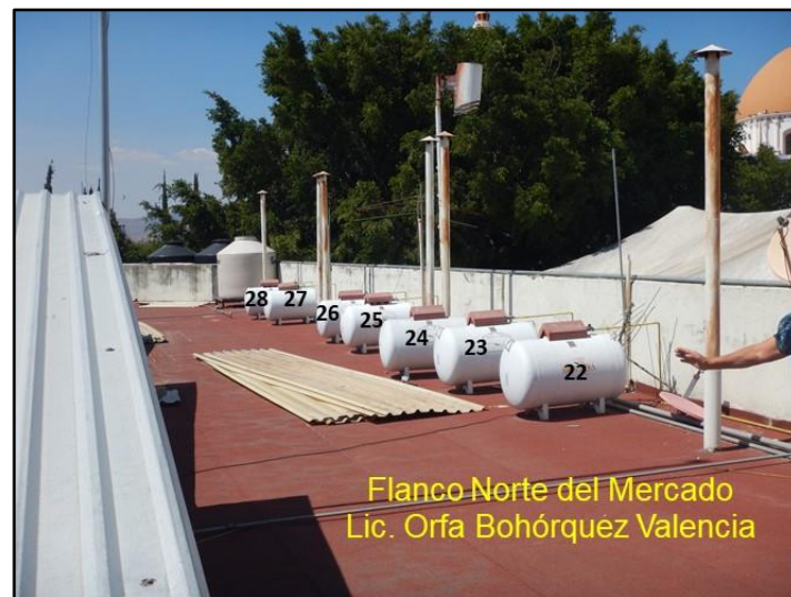
Fotografía 2.78. Ubicación norte de 7 de Tanques con 500 kg de Gas L.P.
