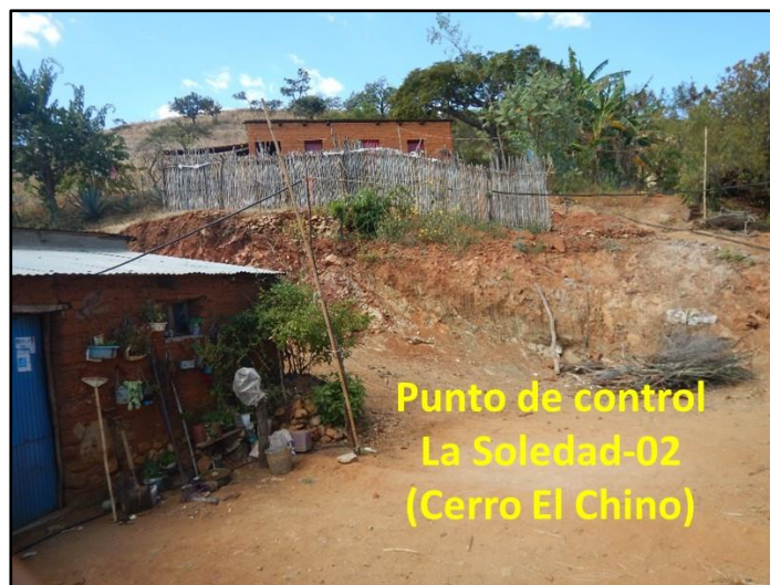
Fotografía 2.15. Sitio de Control Geológico La Soledad-02 con posibilidad de deslizamiento.
