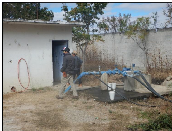
Fotografía 2.29. Condiciones actuales y de operación del Pozo Esquipulas.
