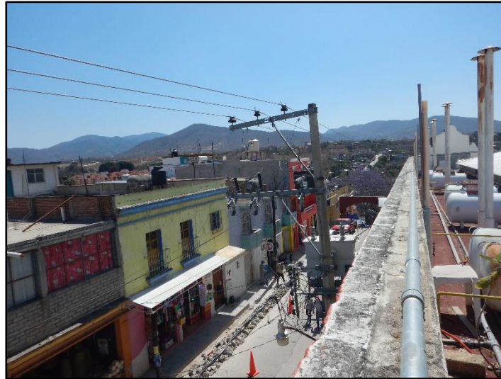
Fotografía 2.61. Ubicación de transformador propiedad de CFE a menos de 2.0 m de los tanques con Gas LP.
