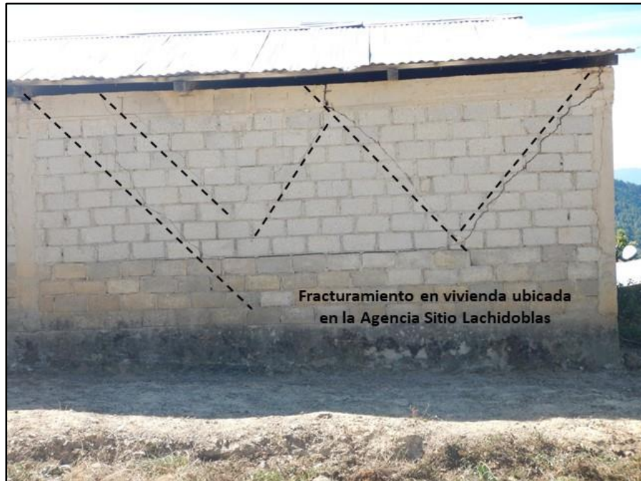
Fotografía 2.3. Afectaciones por eventos sísmicos en la Agencia Sitio Lachidoblas, Miahuatlán.
