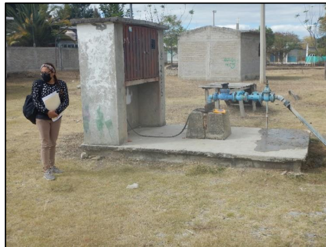
Fotografía 2.28. Condiciones actuales y de operación del Pozo Benito Juárez.
