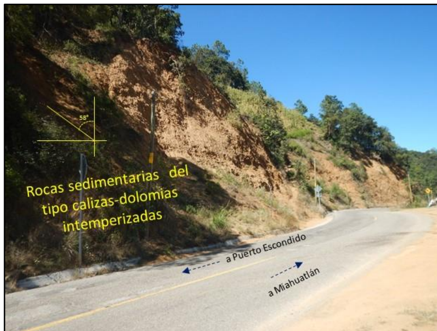
Fotografía 2.12. Sitio Roatina-02 con posibilidad de deslizamiento.
