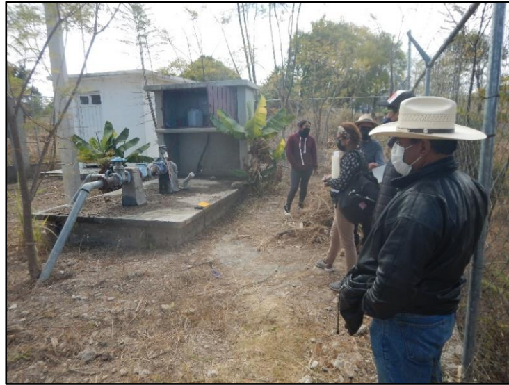
Fotografía 2.30. Condiciones actuales y de operación del Pozo Los Mezquites.
