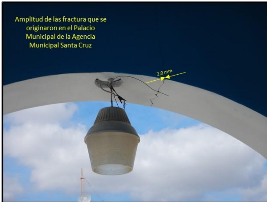
Fotografía 2.2. Afectaciones por eventos sísmicos en la Agencia Santa Cruz.
