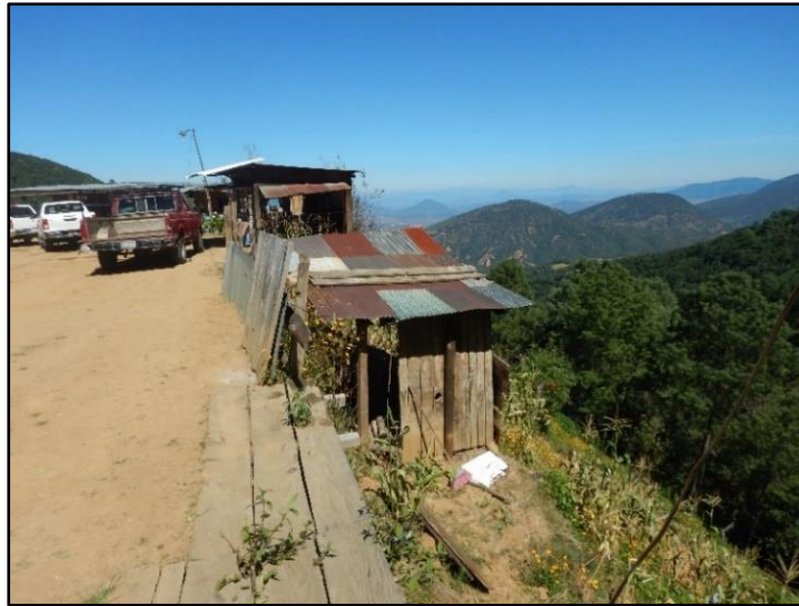
Fotografía 2.66. Tipo de Vivienda I ubicada en la Agencia Municipal de Santa Catarina Roatina con posible afectación por inestabilidad de laderas.
