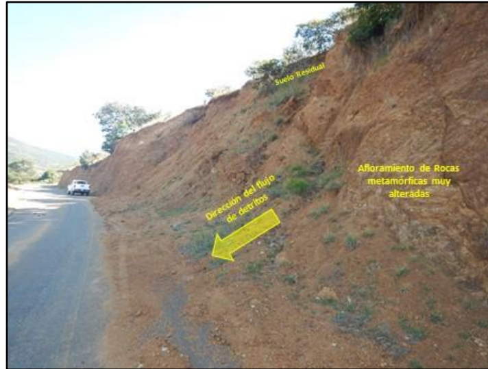
Fotografía 1.2. Deslizamiento de detritos sobre la carretera que une a las localidades de San Pedro Coatlán y Santa Catarina Coatlán.
