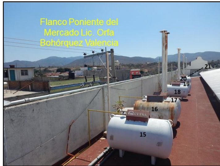
Fotografía 2.77 Ubicación poniente de 7 de Tanques con 500 kg de Gas L.P.
