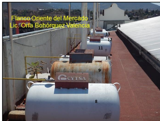
Fotografía 2.76. Ubicación oriente de 7 de Tanques con 500 kg de Gas L.P.
