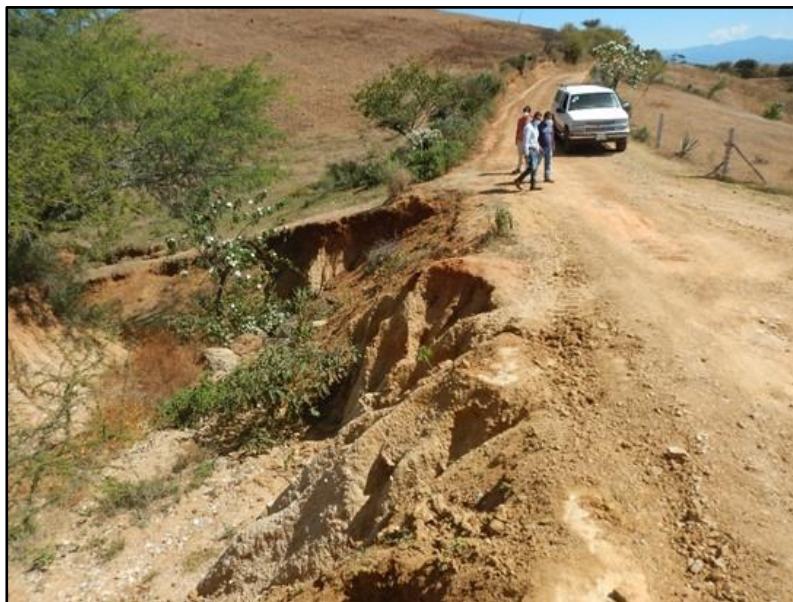
Fotografía 2.7. Visita al sitio donde se tiene inestabilidad de ladera en compañía del Agente Municipal de La Soledad.
