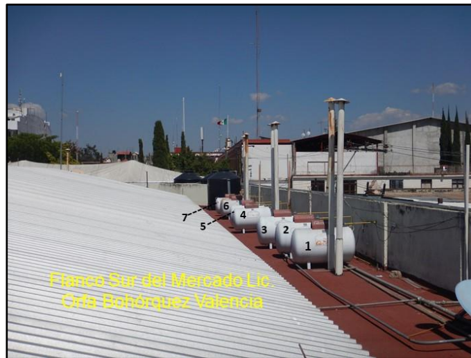
Fotografía 2.75. Ubicación sur de 7 de Tanques con 500 kg de Gas L.P.
