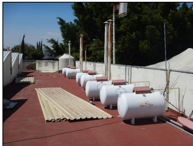
Fotografía 2.60. Ubicación (norte) de tanques con Gas LP en la azotea del mercado municipal.
